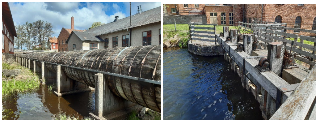
Figur 9. Tuben vid Forsviks vattenkraftverk. Figur 10. Dammluckor vid Forsvik vattenkraftverk. (Foto: Länsstyrelsen i Jönköpings län, 2022-05-12).
