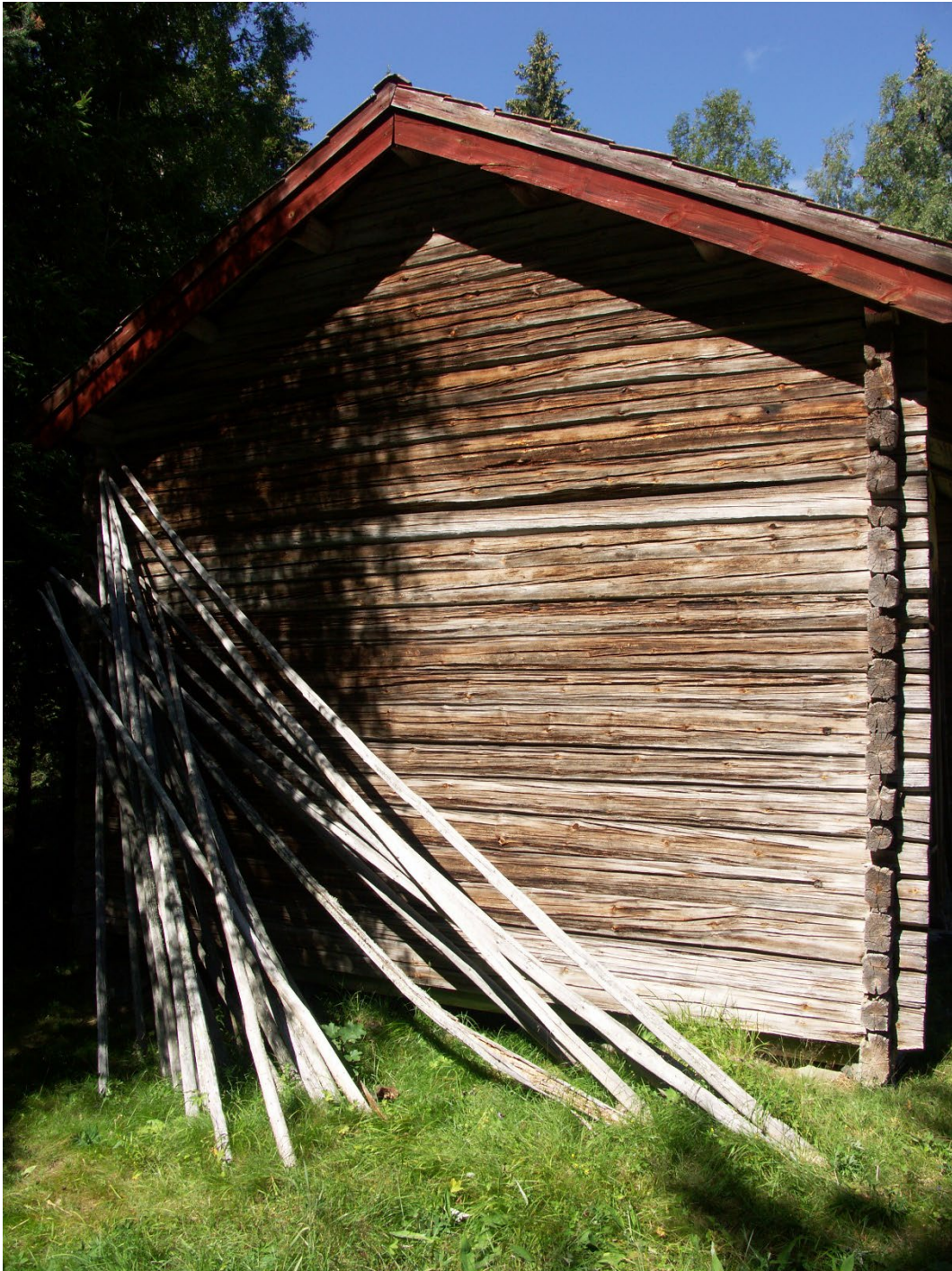
Figur 6. Timmerhusens rektangulära knutskallar är ett typiskt 1800-talsutförande. Foto: Länsstyrelsen i Dalarnas län.
