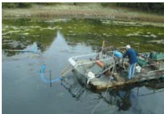
Plattform med stor upptagare och avvattning.
