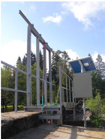
Bild 2. Utöver själva fiskräknaren som är nedsänkt i vattnet består anläggningen för fiskräkning av en service-/underhållsbrygga, lyftanordning, instrumentskåp för dator och modem m.m. samt solpanel för strömförsörjning. Foto: Daniel Johansson
