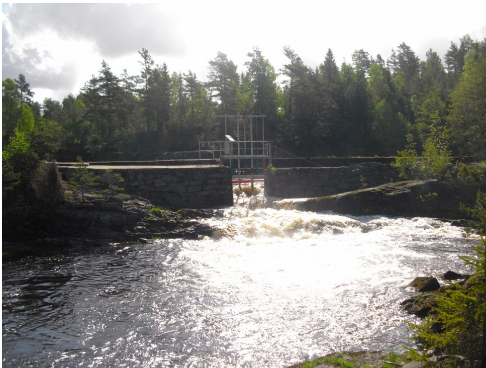
Bild. Mjölnerödsdammen, Enningdalsälven. Fiskräknaren är installerad i ett av dammens utskov. Foto: Daniel Johansson
