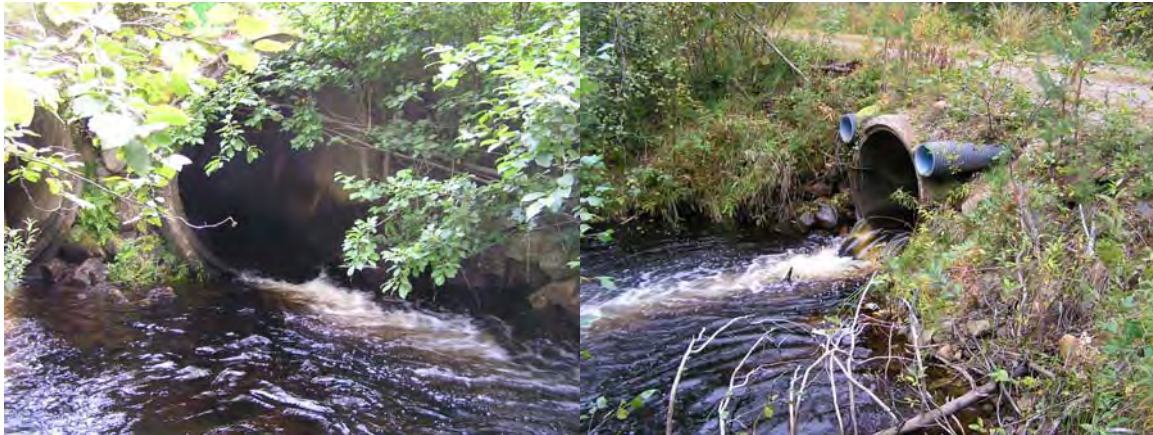
Figur 18. Felpplacerade vägtrummor i Blåbergssjöbäcken vid vägen från Övre Nyland samt vid den lilla vägen ca 300 m ovanför. (Foto förf.)
