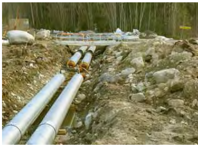
Umeå Energis 13 km långa fjärrvärmekulvert till Holmsund.
