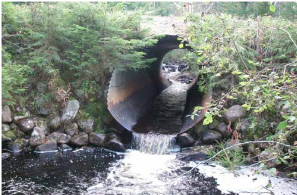
Figur 32. Vägtrummor som anlagts på ett ogenomtänkt sätt blir ofta svåra vandringshinder. De blockerar vattendragets konnektivitet helt i onödan.
