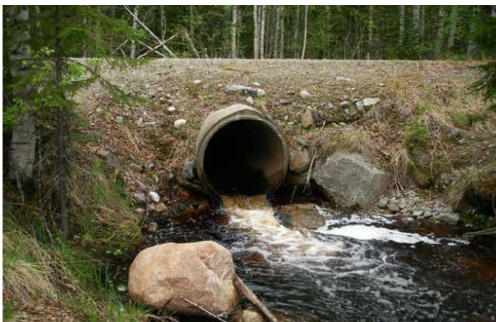
Figur 18. De trummor som anläggs där vägar passerar vattendrag blir ofta vandringshinder.
