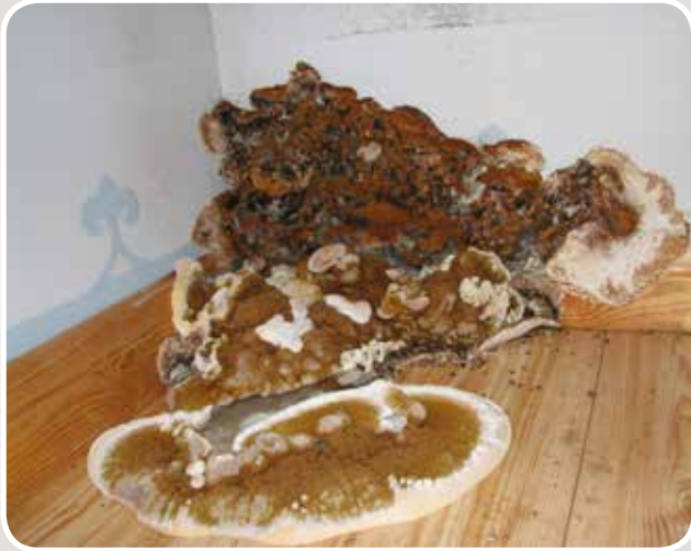
Angrepp av äkta hussvamp i golv, Foto: MYCOTEAM
