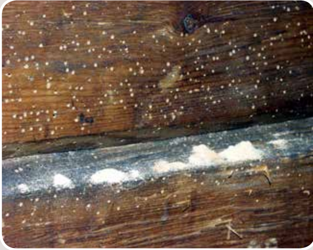
Utflygningshål av strimmig trägnagare, Foto: MYCOTEAM
