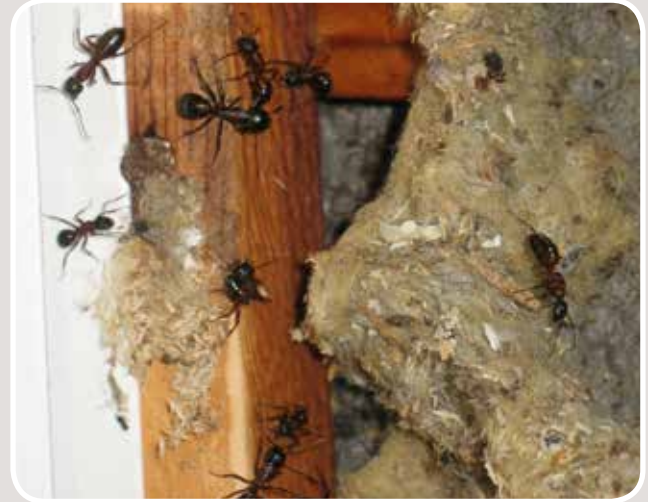
Hästmyror i yttervägg, Foto: MYCOTEAM
