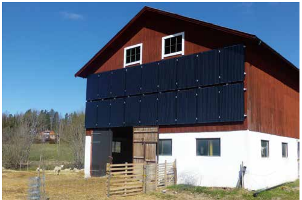
Ett lantbruk utanför Bollnäs med solceller monterade på fasaden. Foto: Ulf Larsson
