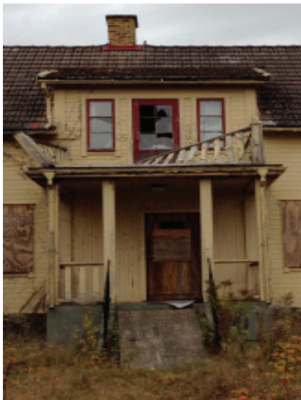
Förfallen byggnad. Foto: Anette Klang
