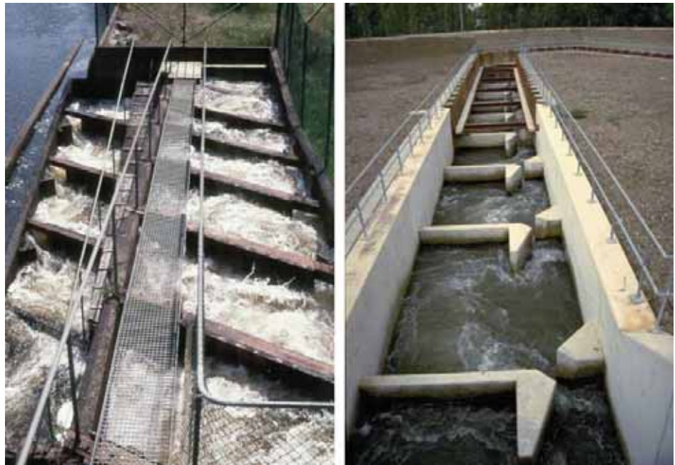
Figur 6. Exempel på en teknisk fiskväg i form av en s.k. slitsränna från Mariebergs kraftverk vid Mörrumsån (vänster) och Ifezheim damm vid floden Rhen (höger). Bilderna visar olika utformning av tvärväggar och de vertikala slitsformade öppningarna i dessa.
