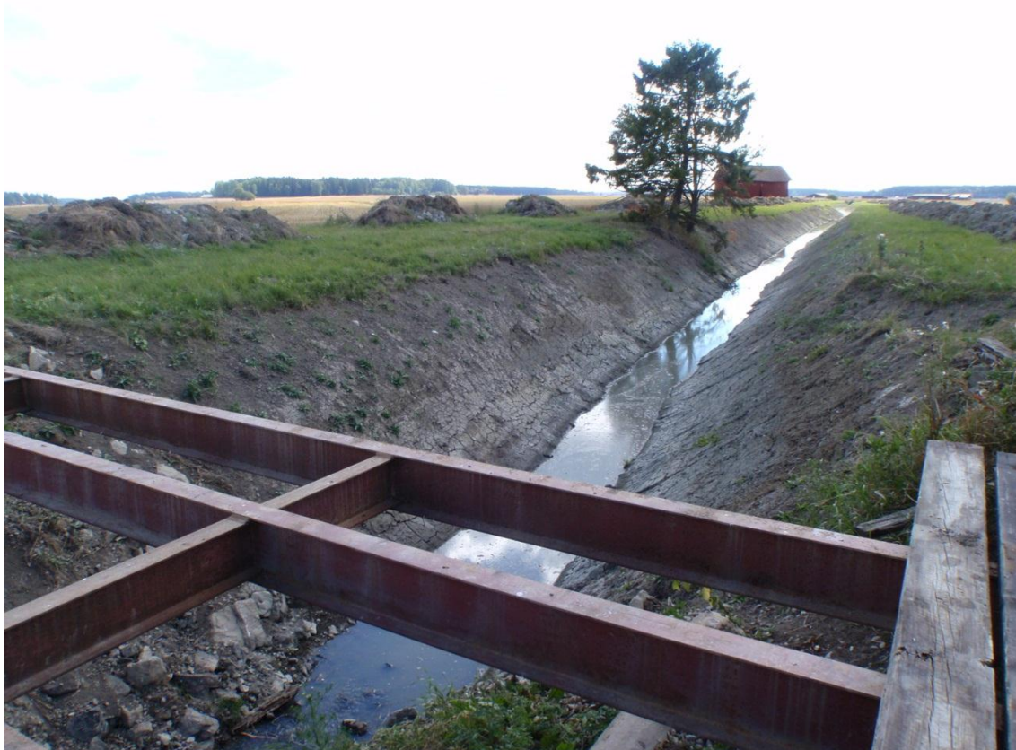
Figur 5. Omfattande dikningsarbete hade utförts både upp- och nedströms lokal U15 Isätrabäcken i Västmanlands län kort tid innan provtagningen 2013. Vattennivån var dessutom mycket låg, © Medins Biologi AB.
