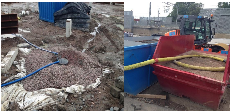
Figur 3.4. Pumpgrop som iordningställt för att avskilja partiklar i länsvattnet till vänster och sandfilter till höger. Foto. A-C. S. Lember
