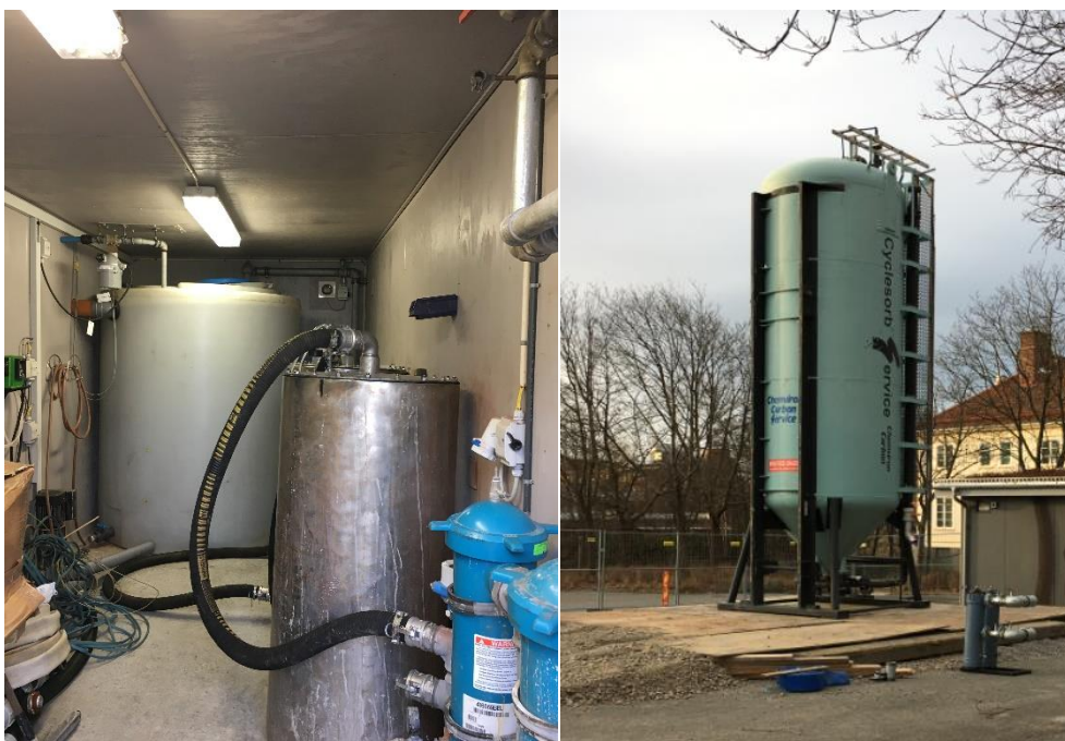
Figur 3.7. Ett mindre kolfilter (längst fram i bild) i container till vänster och stort kolfilter till höger. Foto. A-C. S. Lember
