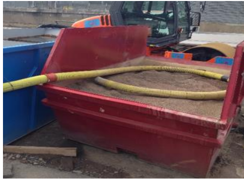
Sandfilter i container. Foto A-C. S. Lember
