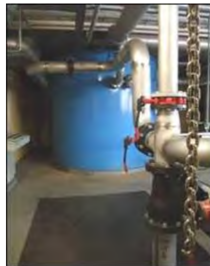
Figur 25. Förhöjt bräddavlopp vid Sköllersta reningsverk (Foto: Daniel Bergdahl).
