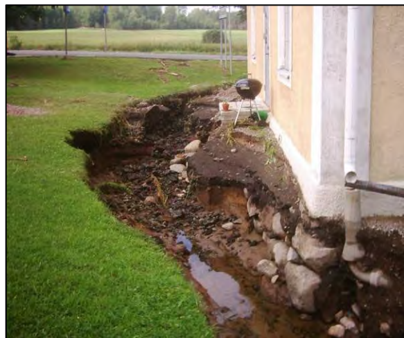
Figur 17. Det var nära att husets hörnstenar spolades bort i samband med skyfallet i Brevens Bruk 2006, vilket hade resulterat i svåra sättningskador (Foto: Gunnar Hadders).
