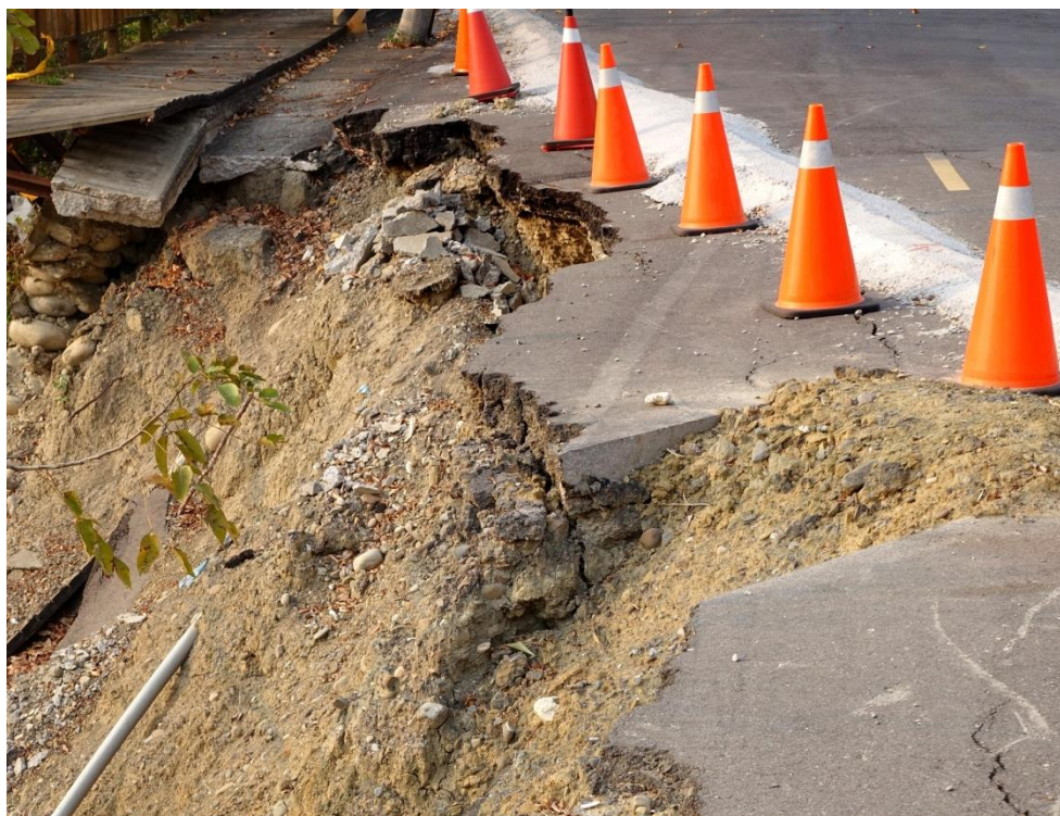
Väg som skadats vid ett ras. Foto: Mostphotos.
