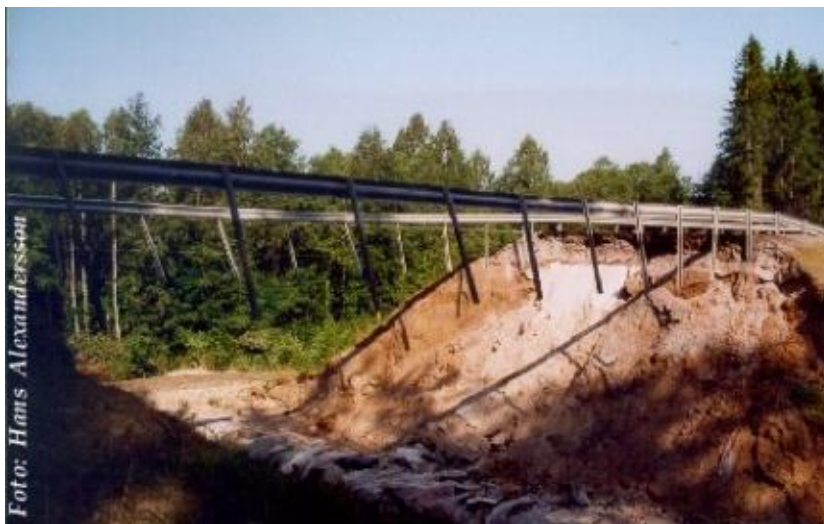
Bortspolad väg efter skyfall 2004
