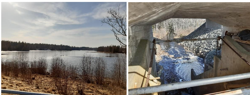
Figur 14. Vy över Risbrodammens regleringsmagasin. Figur 15. Risbrodammens utlopp in i fåran nedströms som leder vidare ner till Klerebodammen. Foto: Länsstyrelsen 2022-03-21.
