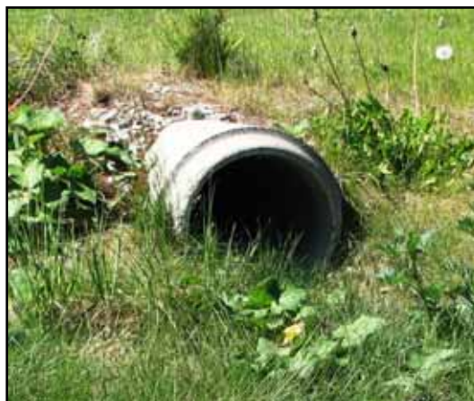
Del av system för dagvattenhantering vid Erikslund i Västerås.
