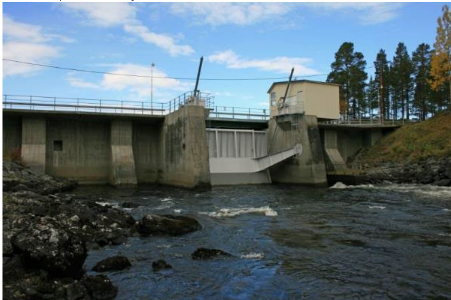
Figur 19. Vid Storsjöns regleringsdamm sker all reglering med en djupt belägen lucka. Det gör att vattentemperaturen riskerar att bli varmare vintertid och kallare sommartid.
