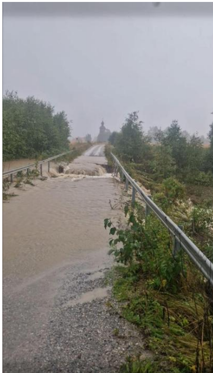
Enskild väg mellan Torsåkers kyrka och Rogsta gård vid Prästbäcken på morgonen 250907. Notera att vattennivån på uppströmssidan är i nivå med vägen. Vägtrumman befinner sig 5-6 meter under vägytan. Foto: Mattias Olsson
