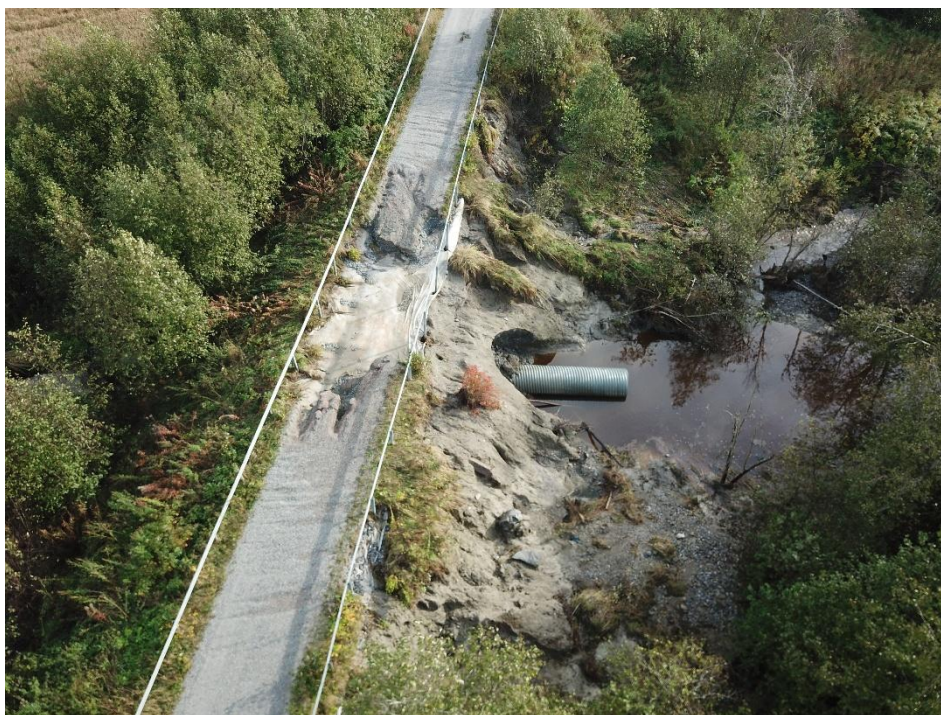
Samma vägsträcka mellan Torsåker och Rogsta gård när vattnet har sjunkit undan. På bilden ses hur vattnet spolat bort hela ytskiktet och kraftigt eroderat nedströmssidan av vägbanken. Foto: Torsten Berglund
