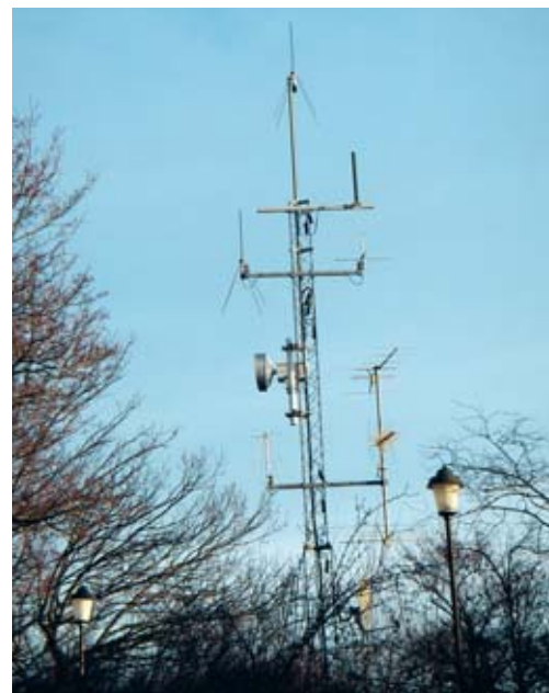
Mast för tele- och radiokommunikation
