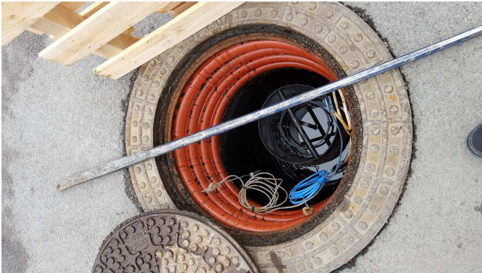
Bild 2. Bilden visar en oljeavskiljare av klass I uppifrån. I oljeavskiljaren syns koalesatorn, flottören för automatisk avstängning samt larmkablar för både hög nivå och oljenivå.
