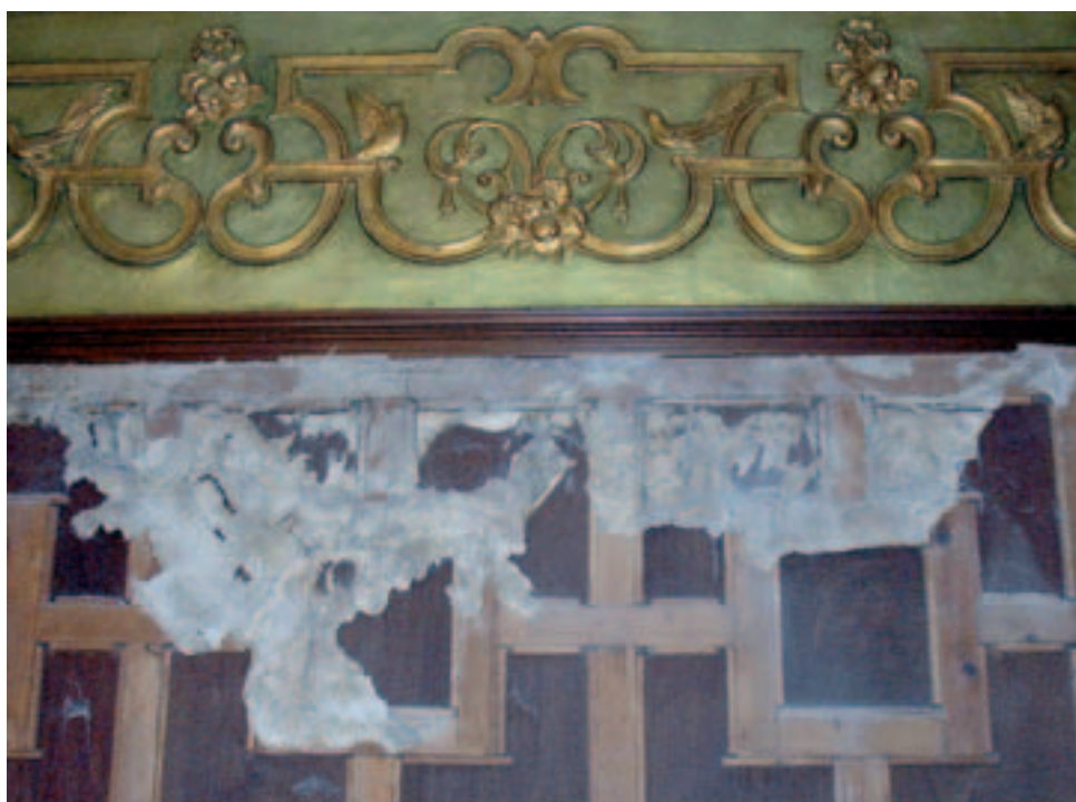
4. I rum 407, Boudoi- ren, fanns svåra svamp- ~angrepp bakom vägg- panelen. Januari 2003.
