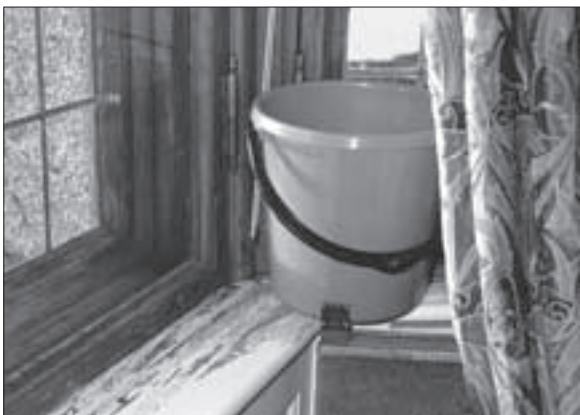
2. Vatten läckte in genom fönstren. Vita Gästrummet 502 före restaureringen, januari 1999.
