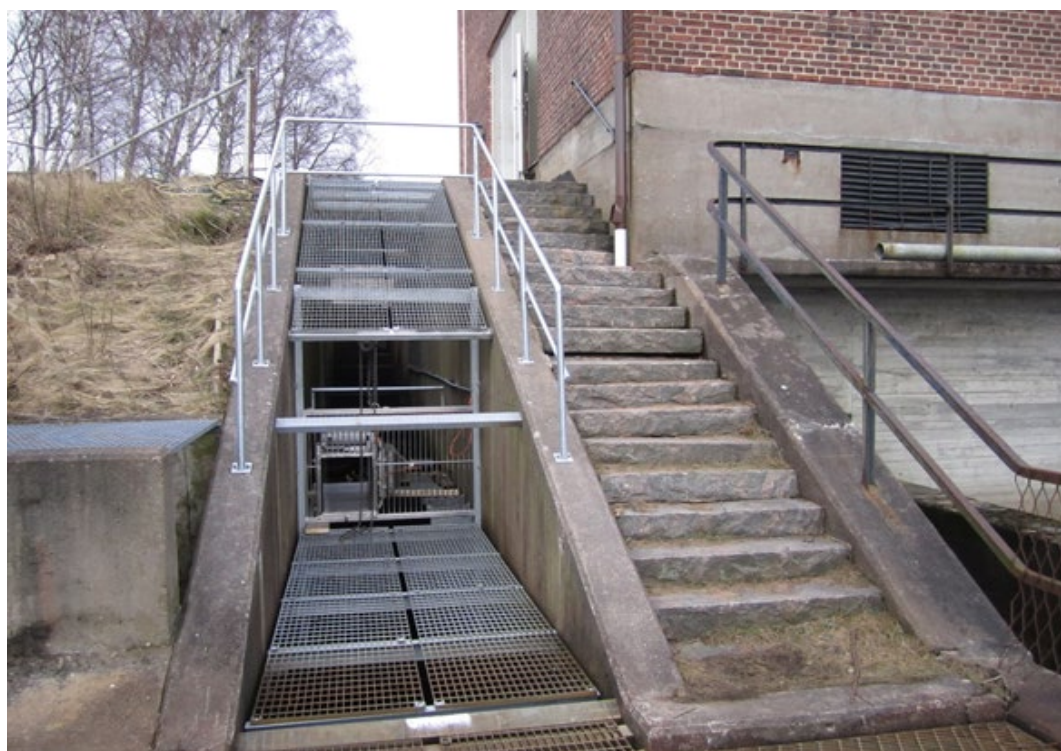
Figur 6. Fiskräknare placerad i nedre delen av kraftverkets fiskväg.
