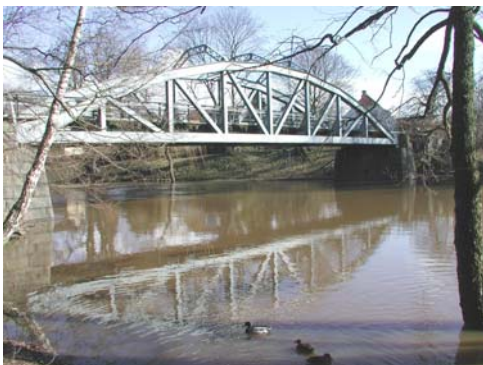
Fd järnvägsbro över Rönne å i Ängelholm är ett parabelfackverk och uppfört 1904. Foto: Daniel Melchert
