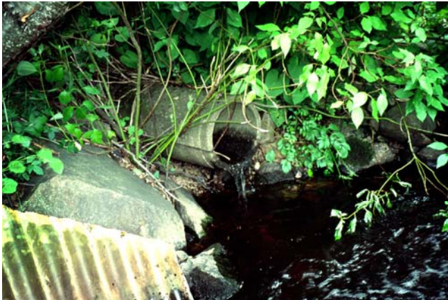
Ett täckdike från ett tätortsområde som mynnar ut i Axeltorpsbäcken/Örebäcken. Foto: Samuel Hylander
