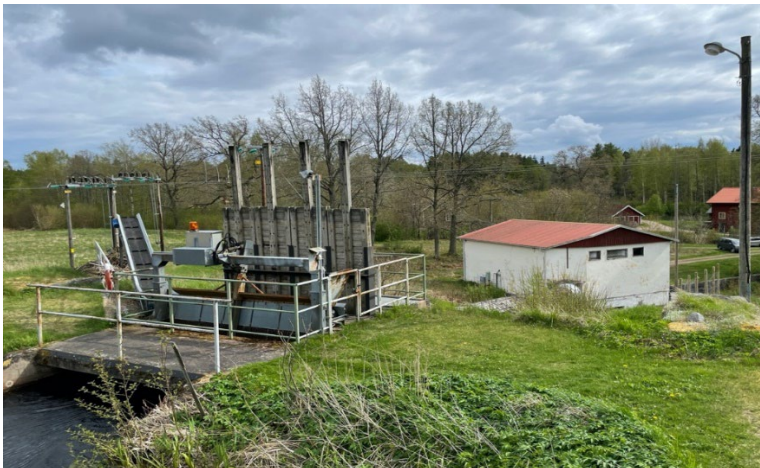
Figur 29. Intagsdamm och kraftstation vid Sättra nedre kraftverk.
