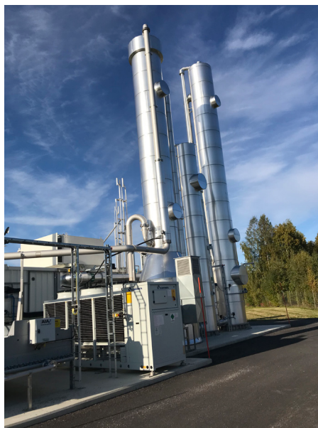
Tankstation för biogas, Skellefteå
