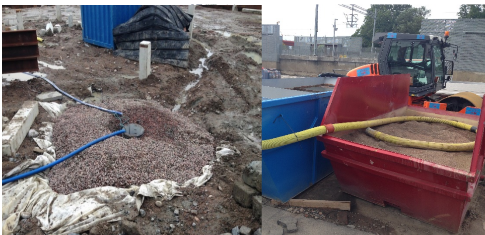
Figur 3.4. Pumpgrop som iordningställts för att avskilja partiklar i länsvattnet till vänster och sandfilter till höger. Foto. A-C. S. Lember
