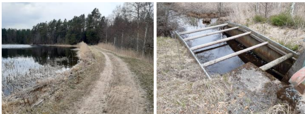
Figur 16. Jorddamm vid Lovsjöns regleringsdamm, sydost om regleringsluckan. Figur 17. Utskovskanalen nedströms regleringsluckan vid Lovsjön. (Foto: Länsstyrelsen 2021-04-29)
