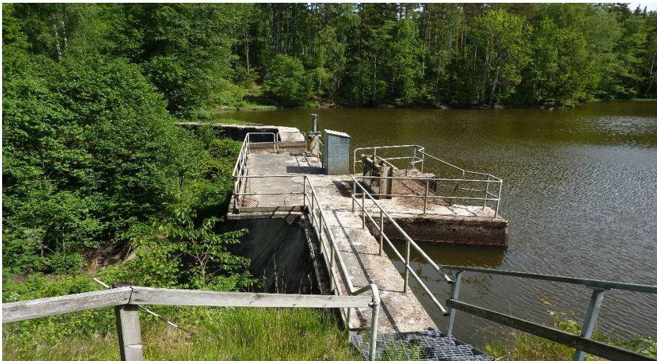
Figur 22. Hällstorps Övre kraftverksdamm med tub av betongrör till Hällstorps kraftstation.
