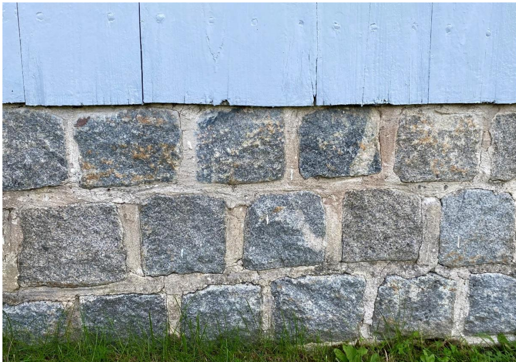
Figur 4. Paviljongen vilar på en naturstensgrund. Foto: Lovisa Lindberg, Länsstyrelsen i Dalarnas län.
