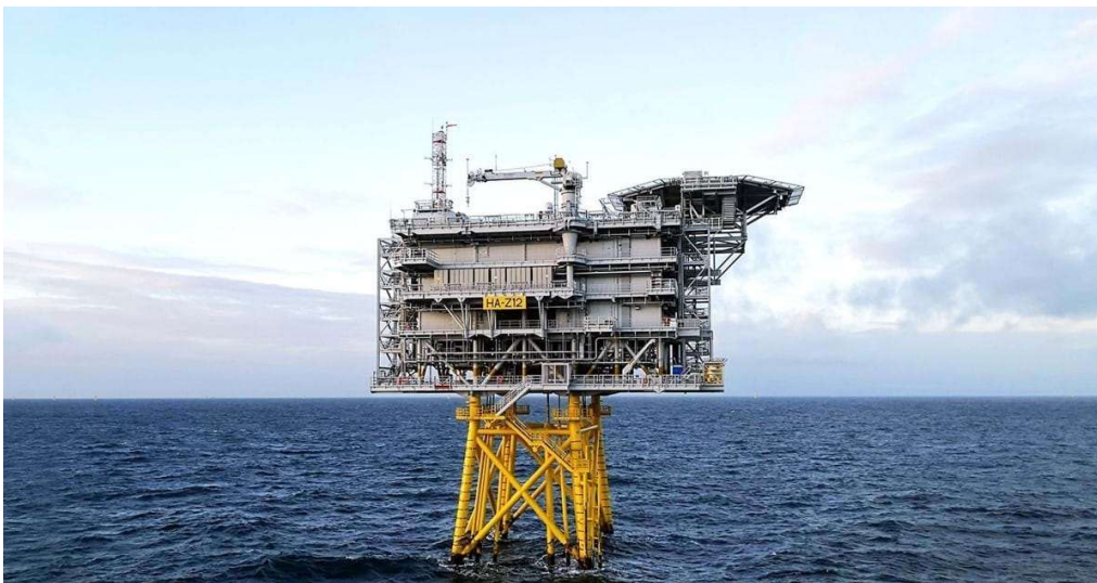
Figur 4.1- Havsbaserad transformatorstation (fackverksfundament)
