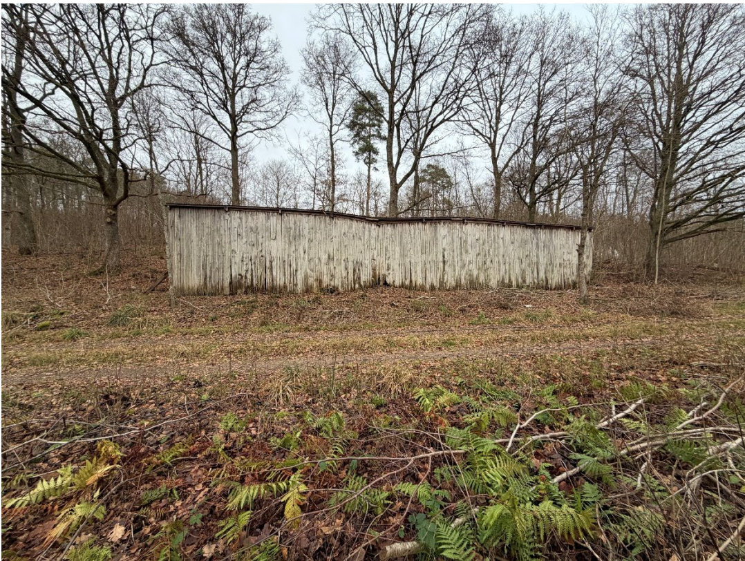
6. Överst: Från jordvallen i norr har ett träd fallit över lastbilsgaraget och skadat takkonstruktionen, Marknivån går här högt upp mot fasaden. Nederst: Byggnadens södra fasad har tydliga skador på panel och stomme. Skadorna har lett till en svacka i byggnadens mitt.
