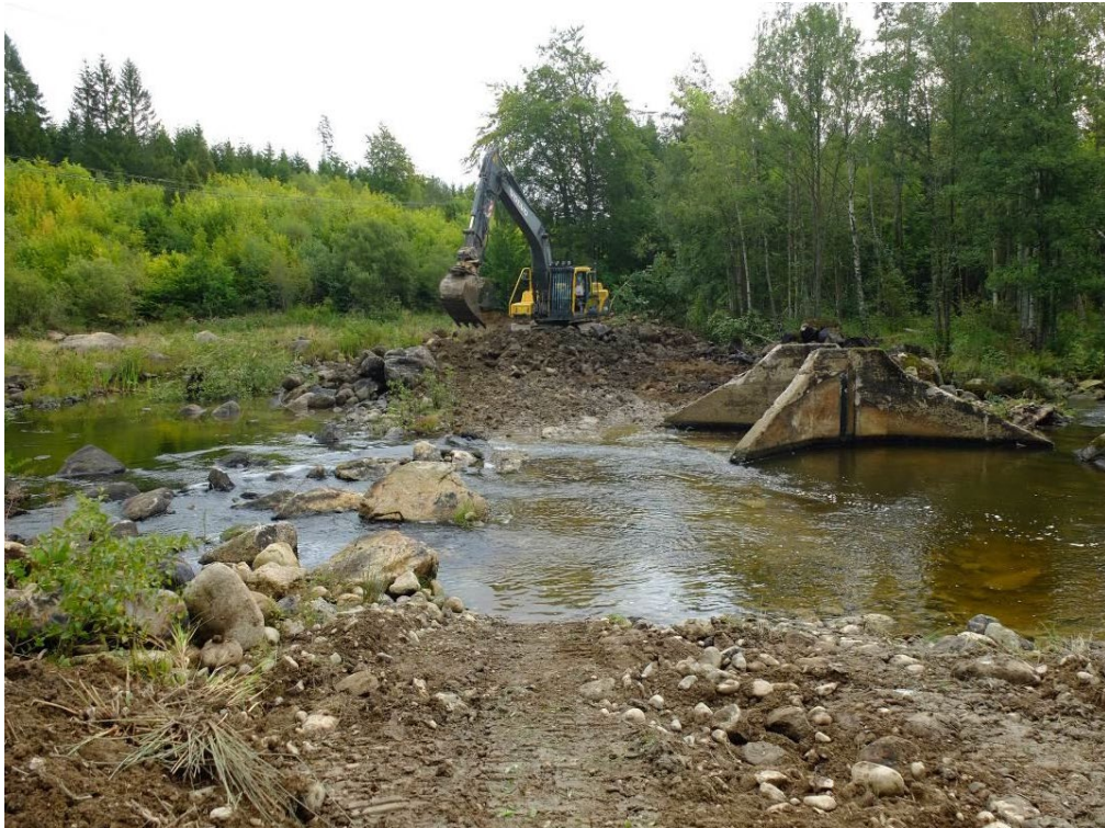
Bild: Restaurering vid en av grunddammarna i Granö torrfåra. Foto: Thomas Nydén & Peter Johansson, Emåförbundet.
