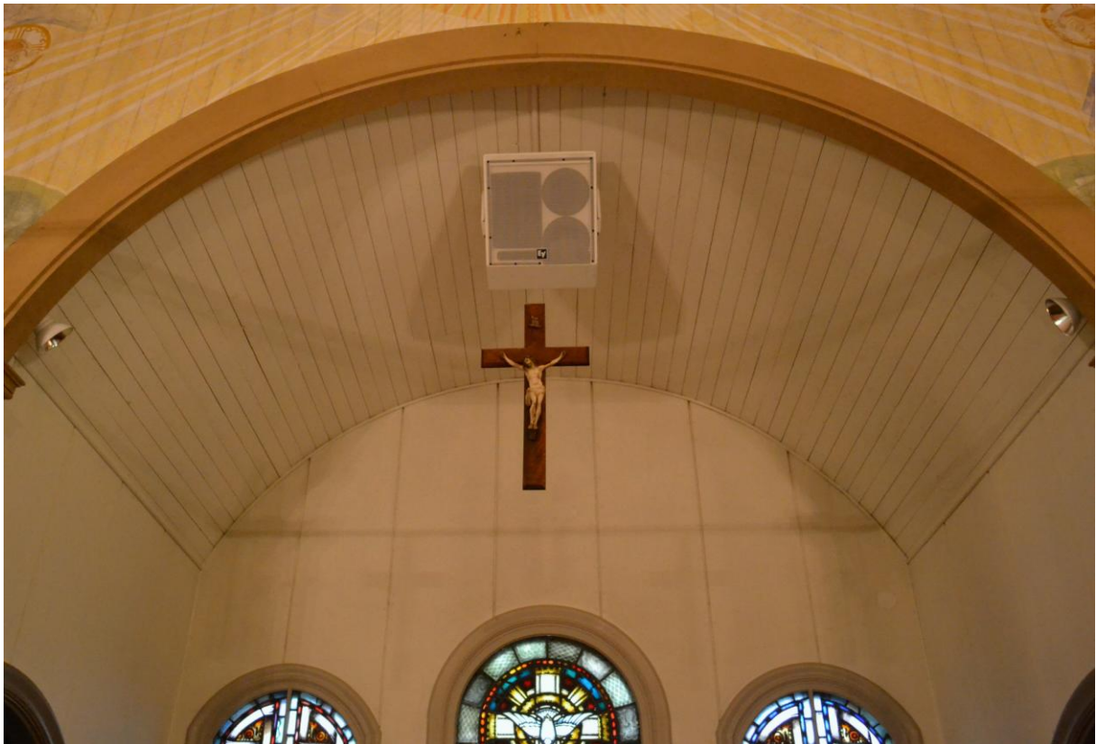
Det befintliga högtalarsystemet utgjordes av en centralhögtalare över koret. Denna kommer senare att tas ner.
