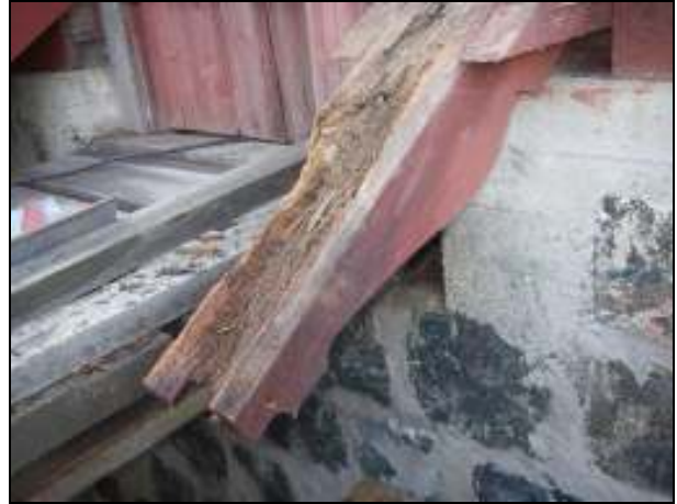
Den rötskadade taktassen
