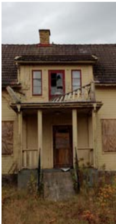
Ovårdad byggnad. Foto: Anette Klang
