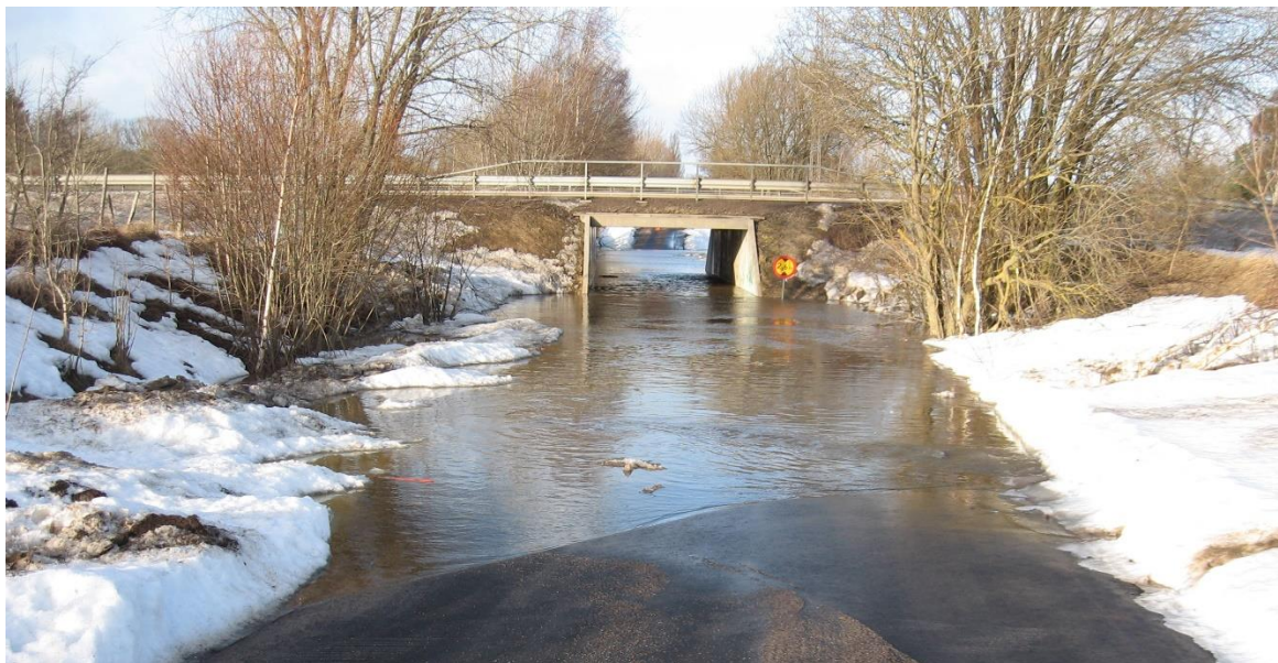
Figur 11. Översvämmad viadukt under väg 137, Möllstorpsgatan i Färjestaden. Foto: Bengt Andersson
