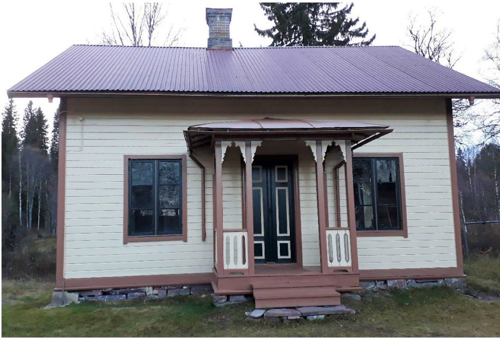
Figur 5. Drängstugan är nyligen renoverad. Den har samma utformning som mangårdsbyggnaden och har den rikt ornerad veranda. Foto: Länsstyrelsen i Dalarnas län.
