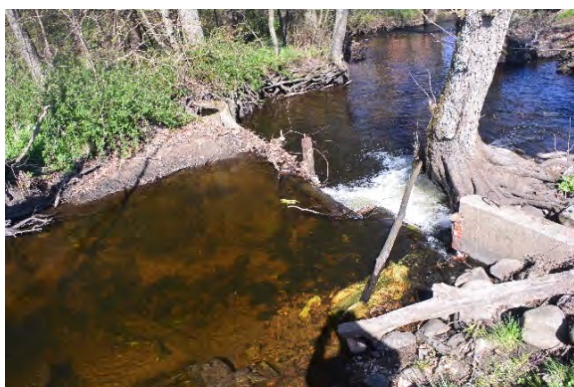
Figur 6. Det mindre dämnet vid Frumölla innan åtgärd.
