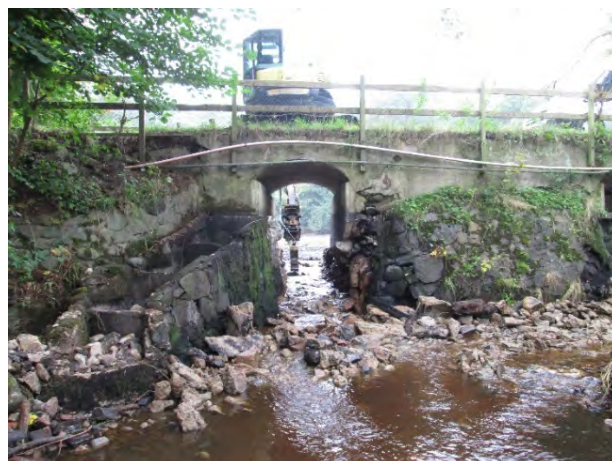
Figur 2. Hösten 2017 sänktes dammen av och fria vandringsvägar skapades. Den före detta fisktrappa syns till vänster.
