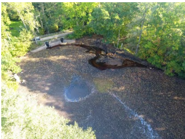
Figur 4. Dammen vid Klintarp direkt efter avsänkning av dämnet.
