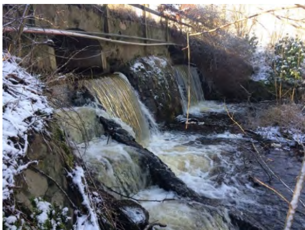
Figur 1. Vid Klintarp fanns tidigare en damm med en fisktrappa som var felkonstruerad, och som inte kunde passeras av fisk.
