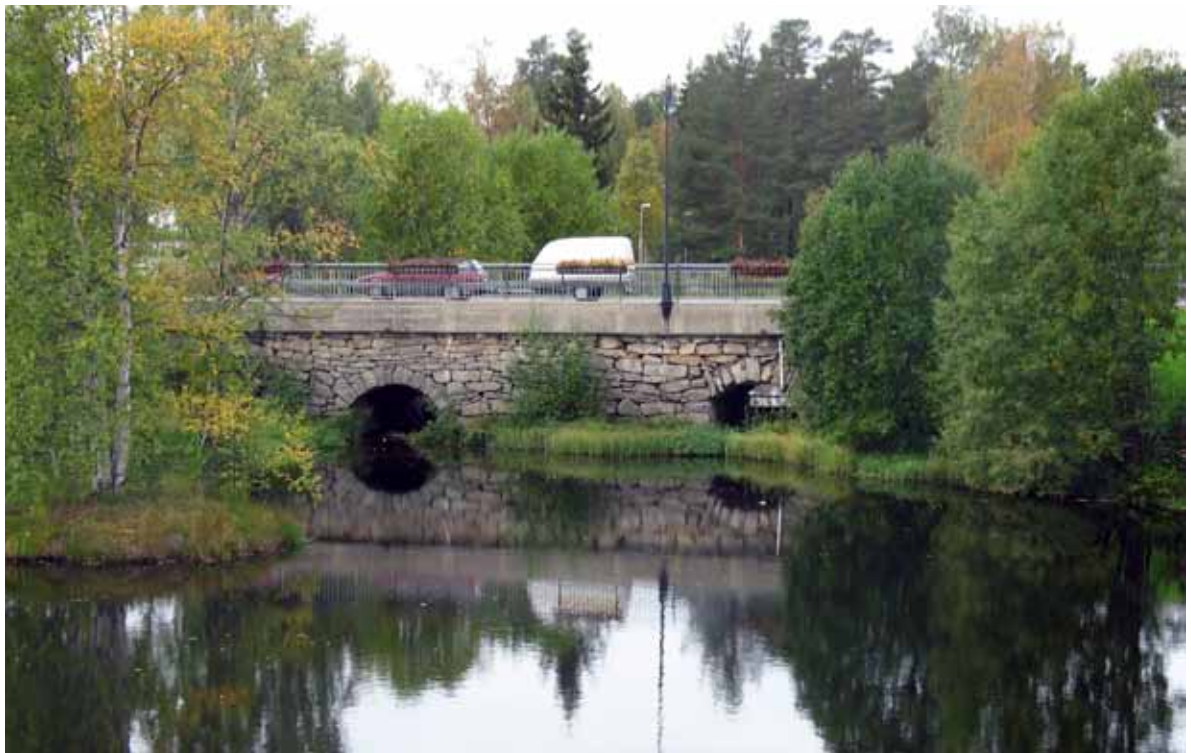
Stenvalvsbro från 1840 som har fått en pågjuten betongplatta, Lycksele, Västerbottens län. Foto: Jeanette Joelsson.
