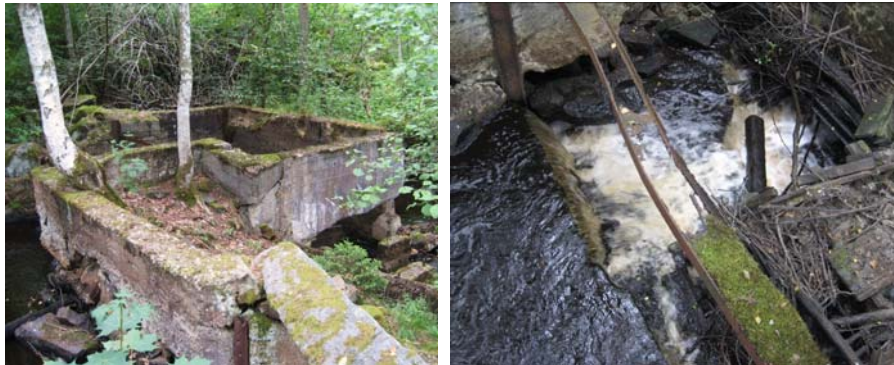
Fig 18. Resterna av ett kraftverk i Lilla Helge å. I resterna av kraftverket finns det tre, ca 30 cm höga steg som utgör ett permanent vandringshinder för många arter. Av den orsaken föreslås att botten genom kraftverket släntas av så att denna fåra möjliggöra vandring upp och ner genom Lilla Helge å.
