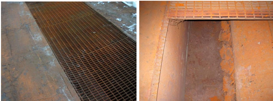
Figur 4. Utsugningsanordning vid f d sprutmålarboxen. Färgrester finns i betongschaktet.
