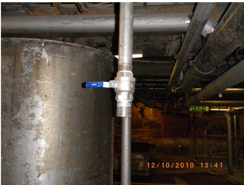
Bild 8: Ventil utan låsanordning. Denna ledning går från en öppen brunn i en kemikalieinvalning i våningen ovanför för att kunna tömma eller rengöra denna när så krävs. Om ventilen glöms i öppet läge föreligger risk för kemikalieläckage vidare ut i dagvatten nätet. Sådana här ventiler ska förses med låsanordning.
