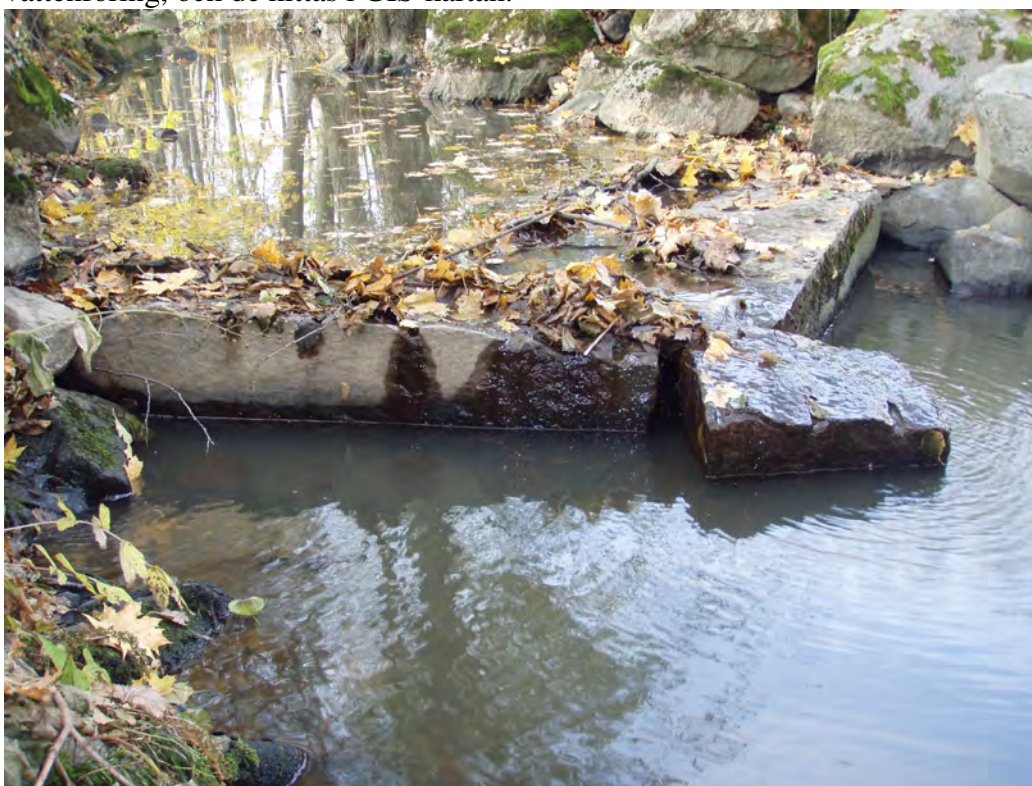
Figur 6. Vandringshinder i Binån som gör det omöjligt för fisk att passera uppströms. Foto Länsstyrelsen.
