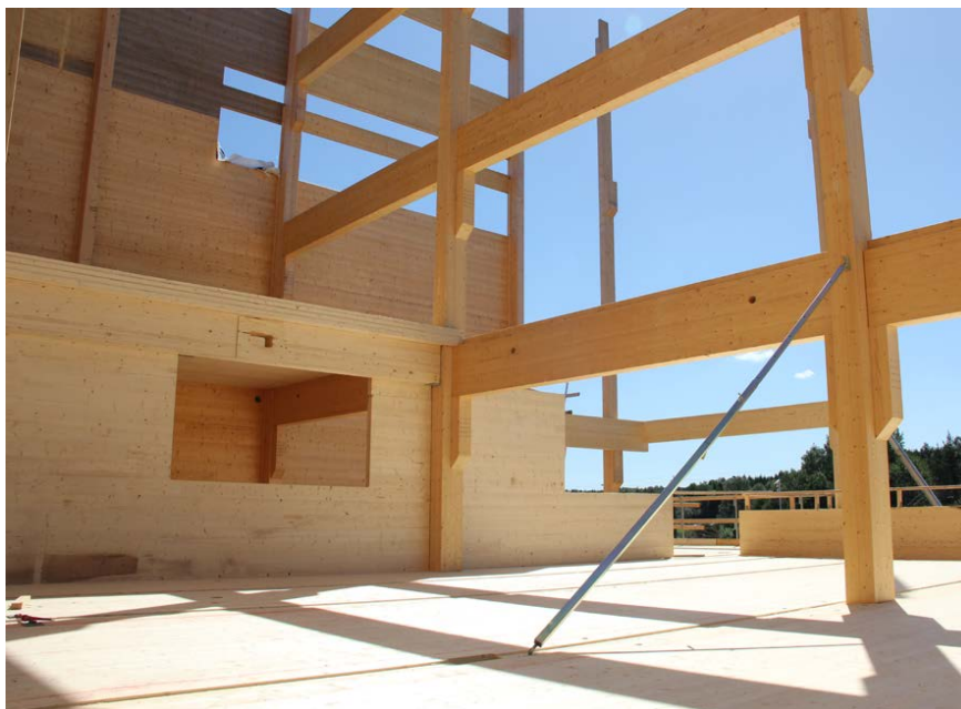
Bild från Kniustas nya Centrum för Idrott och kultur som byggs med trästommar vilket ger en lägre klimatpåverkan än betong.
