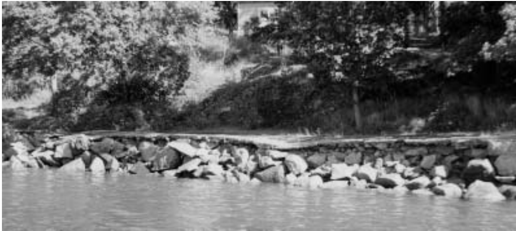
Figur 2: En skada som denna visar på en hög erosionsaktivitet och betraktas i inventeringen som en svår skada, med en tydlig erosionsbrink på 0,5 meter eller mer. Foto: Lars Granath.
