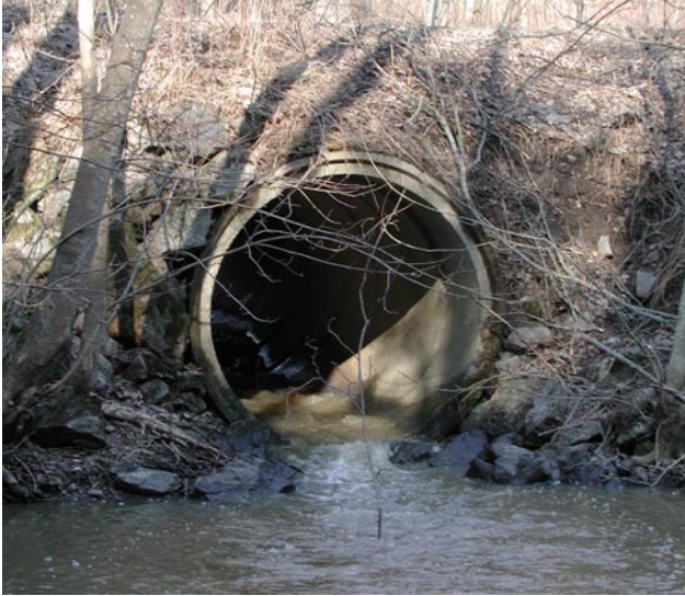
Exempel på en felaktigt placerad vägtrumma, med litet vattendjup, hög vattenhastighet samt avsaknad av naturligt bottenmaterial. Skillebyån, punkt 2.
