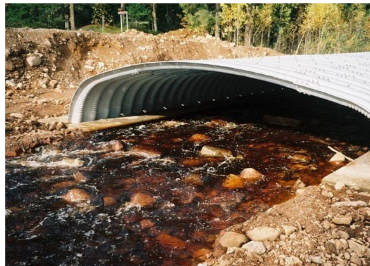
En så kallad valvbåge som Vägverket låtit ersätta en tidigare felplacerad vägtrumma i ett biflöde till Unnån i Dalarna.
