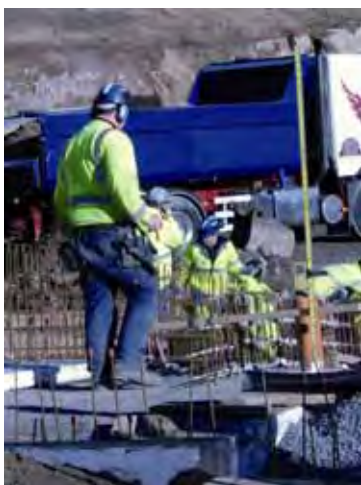
Rekryteringsproblem i byggbranschen kan påverka bostadsbyggandet de kommande åren. Det är brist inom i stort sett alla yrkesområden. Enbart i Stockholmsregionen sysselsattes 50 000 personer i 11 500 företag i byggbranschen år 2007. Foto: Henrik Weston / Länsstyrelsen i Stockholm.
