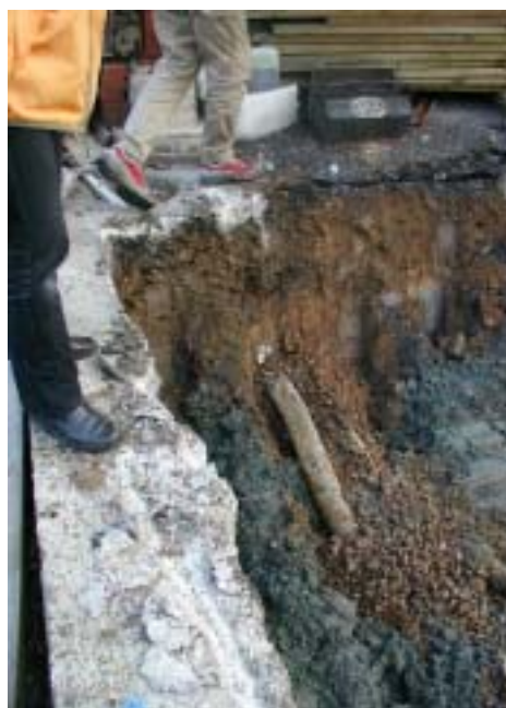
Figur 5: I ledningsgravar är materialet grövre (det bruna gruset) och innebär ökade spridningsförutsättningar i jord som till synes kan verka tät (den gråblå leran på bilden). Foto: Linda Bengtson.
